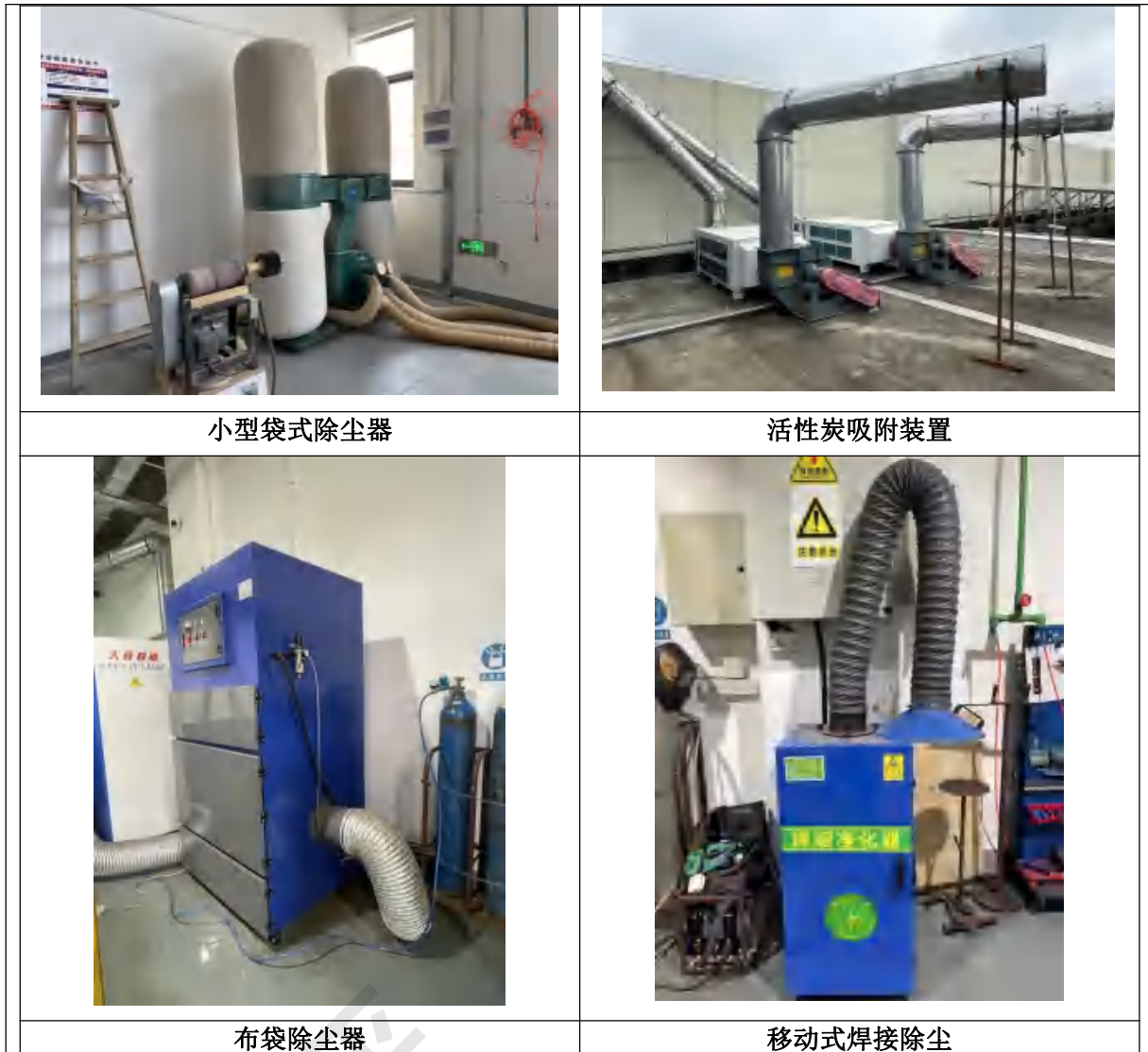
图 3-2 废气处理设施现场图
