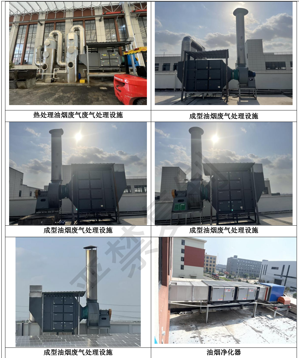
图 3-2 废气处理设施现场图
